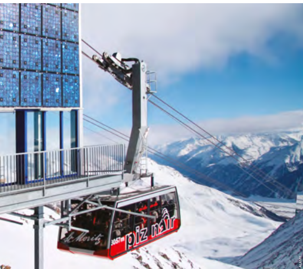
Installation photovoltaïque à la station d'arrivée du téléphérique du Piz Nair, aux Grisons.
