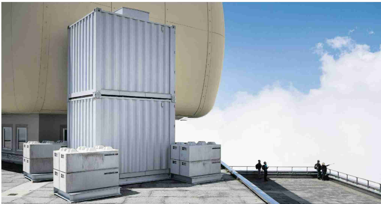
Spiegel, die sich in den grauen Containern befinden, lenken den Laserstrahl aus dem beigen Dom entlang der Swisscom-Antenne in die Höhe.
